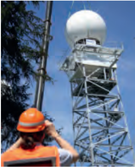
Präzisionsarbeit mit dem Baukran ist gefragt bei der Radareneuerung auf dem Albis im Mai 2012.
